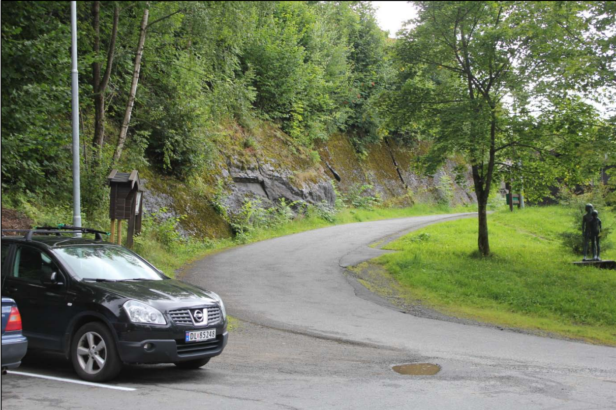
Kraftig tilvokste lagflater ved Heggelia. Informasjonsskilt til venstre. Foto: Ole A. Hoel.
