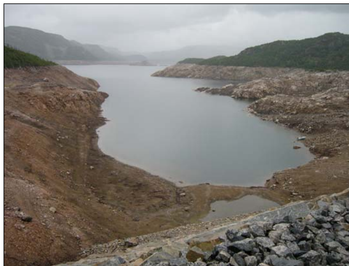
Fig. 28. Bordalsvatn i midten av august 2006, med vannstand ca 30 m under HRV. Foto: Finn Johansen, Fylkesmannen i Telemark.
