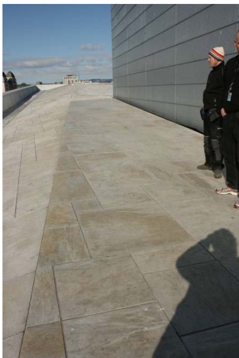
Figur 3. Misfarging av marmor på horisontal takflate, svakere misfarging på den skrå flaten som heller mot sørvest. Fotoet er tatt mot nordvest. Til høyre står Ingar Reinsborg og Thomas Fredriksen, Statsbygg. Foto: E. Roaldset 22.03.2013
