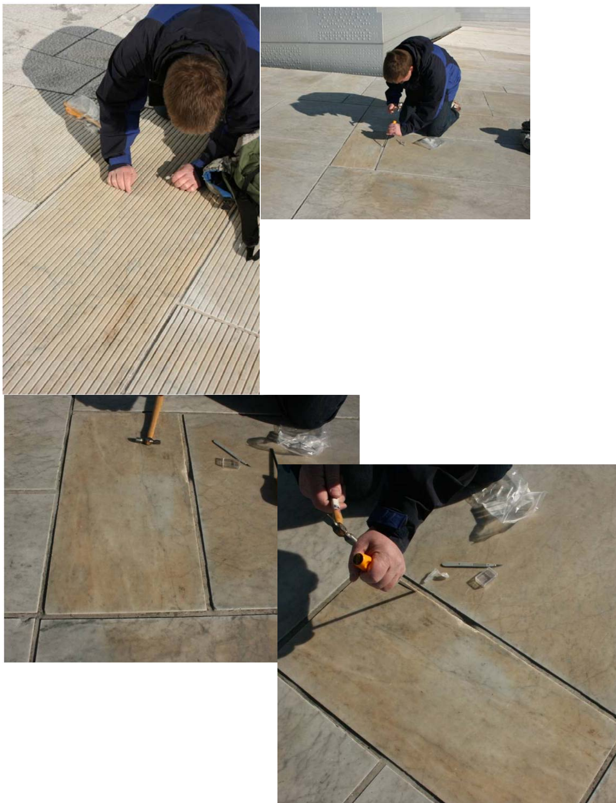
Figur 5. Prøvetaking på vestsiden av operataket. Både riflete og glatte flater har misfarging. Rune S. Selbekk tar små prøver av belegget med litt av underlaget. Foto: E. Roaldset, 22.03.2013.
